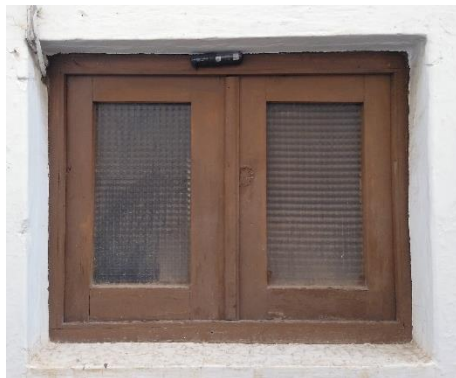
Data logger situado en el exterior
